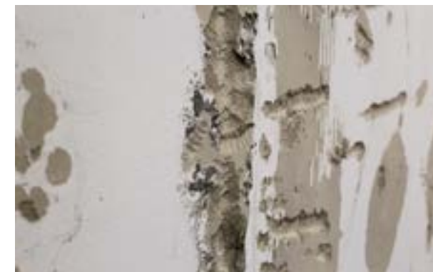
Zdjęcie nr 2. Pozostałości po poprzednich warstwach wykończeniowych.
