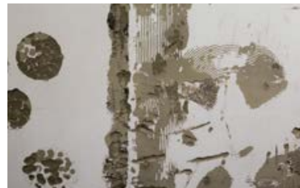
Zdjęcie nr 1. Ubytki do wypełnienia klejem.
