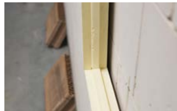
Zdjęcie nr 9. Widok na prawidłowo ustawiony zamek.
