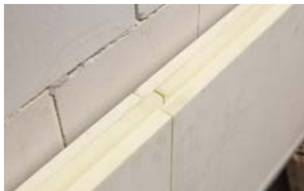
Zdjęcie nr 7. Widok na prawidłowo ustawiony zamek.
